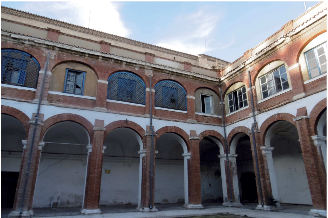
Humedades y deterioro de cornisas y fachada interior claustro
