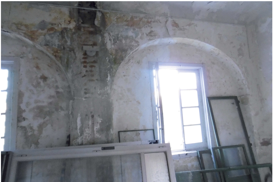
Humedades de fachada por filtración
