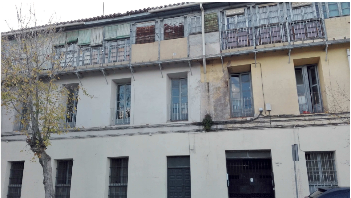
Humedades y gran deterioro de fachada exterior
