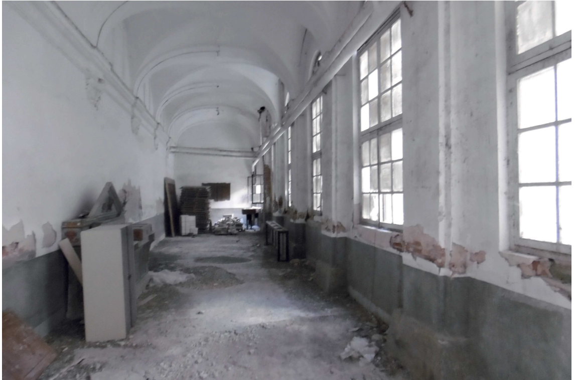
Humedades en muros de naves laterales por capilaridad
